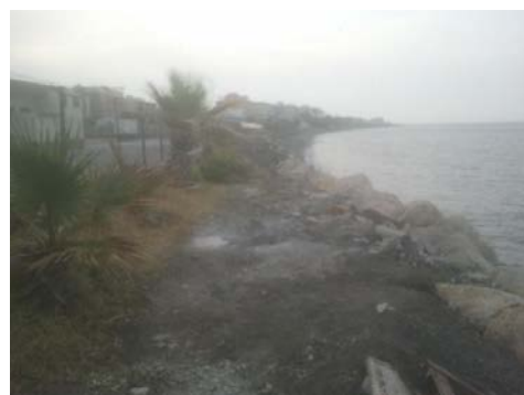
WPT6. Tramo peligroso
