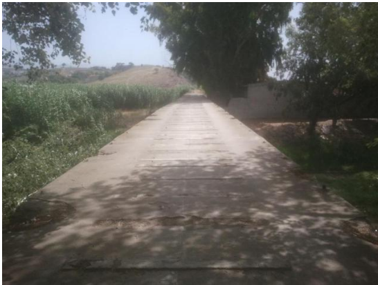
WPT15. Puente sin barandilla
